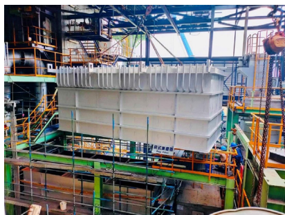
空気汚染防止装置の更新：バグフィルター (2022年09月26日)
